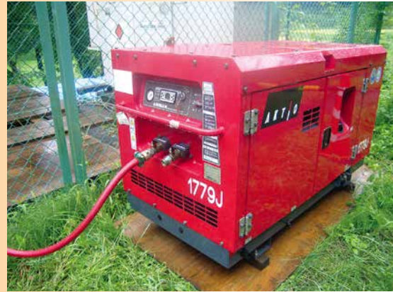
エアコンプレッサー
