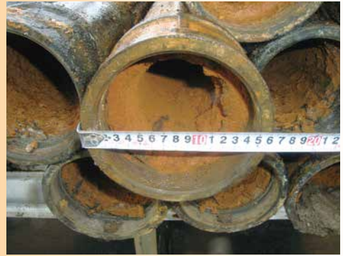
揚水管内付着物状況
